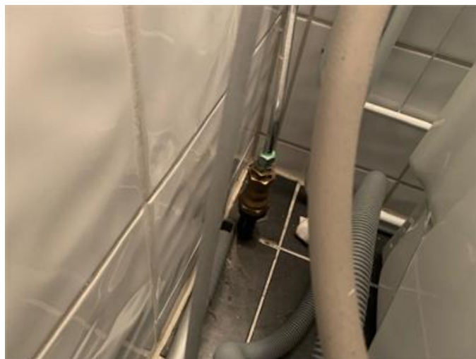
Rör genomföring i golv tvättutrymme.
