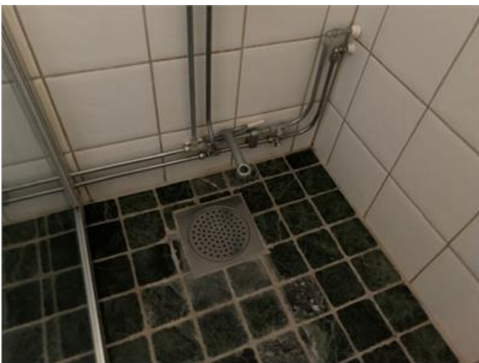
Golvbrunn nära vägg (under 20cm).
