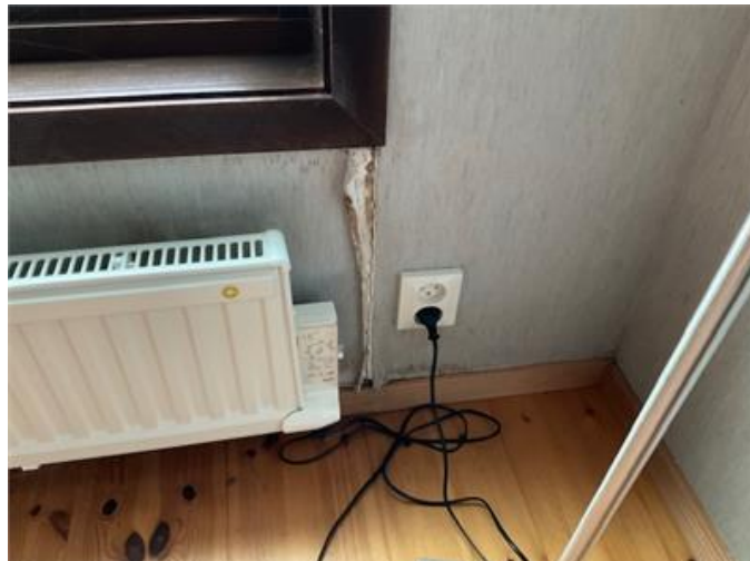
Äldre fuktskada vid fönster i vardagsrum.
