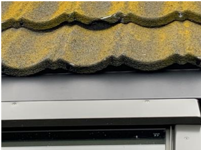
Skada på takplåt.
