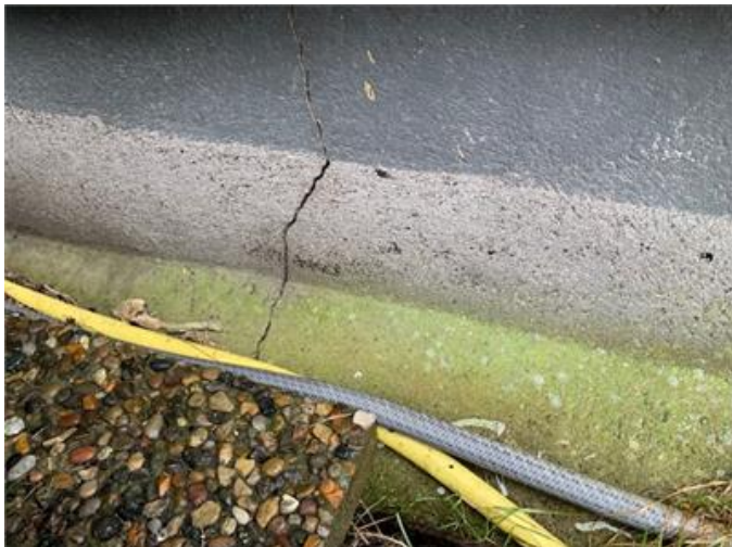
Spricka i sockel.
