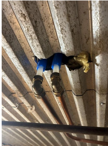
Tappvattenrör upp till våning 2. Brandtätade?
