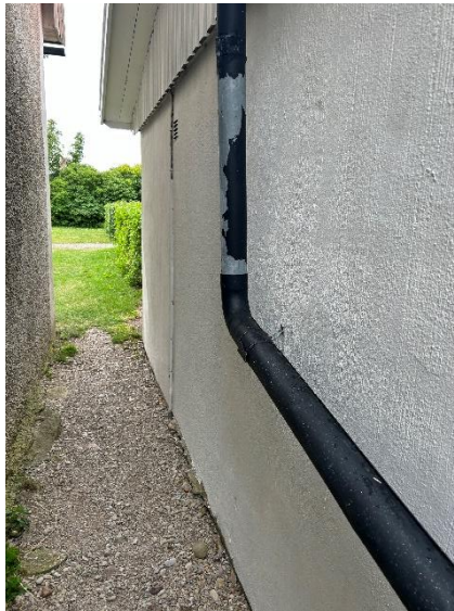
Kopplat stuprör på markledning
