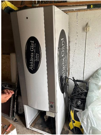
Varmvattenberedare till lilla huset
